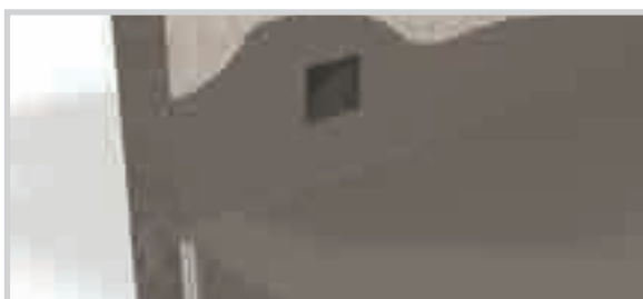
DESAGÜE DE SEGURIDAD.
