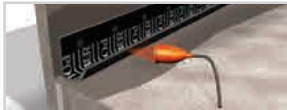
APLICAR BANDA DE REFUERZO.
